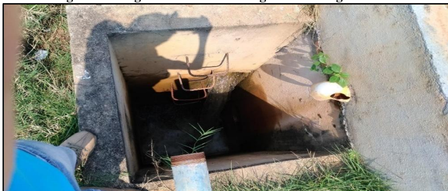
Figura 19—Água Oriunda da Lavagem e Descarga da ETA.
