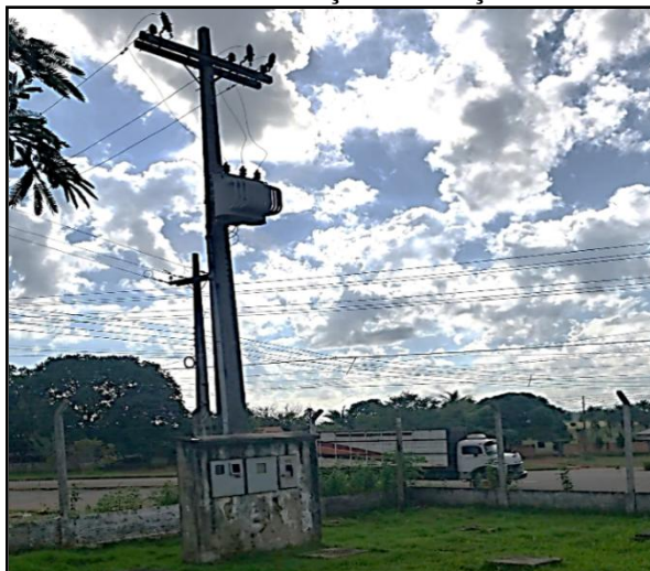
Figura 20—Transformador da Subestação da Estação de Tratamento de Água.
