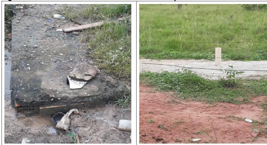
Figura X. Fossas rudimentares na área rural de Urupá - RO.
