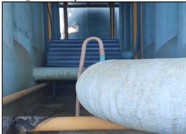
Figura 14—Adição de Sulfato de Alumínio.
